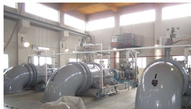
大輪田ポンプ場内部
