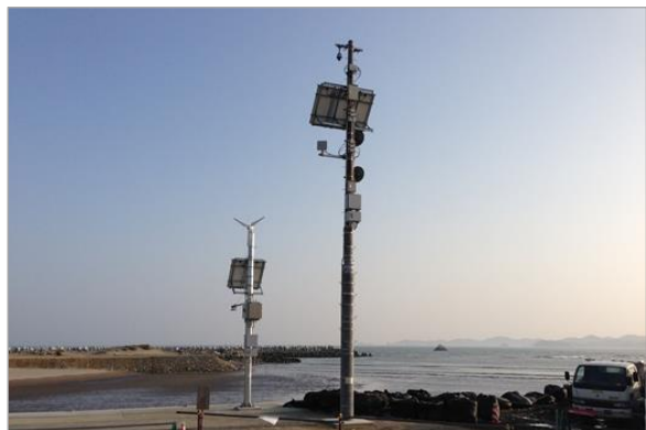
津波監視カメラ
