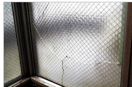
窓ガラスの熱応力破壊
