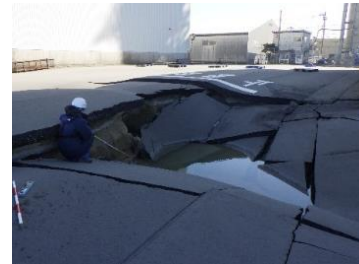
ふ頭用地の陥没(金沢港)
