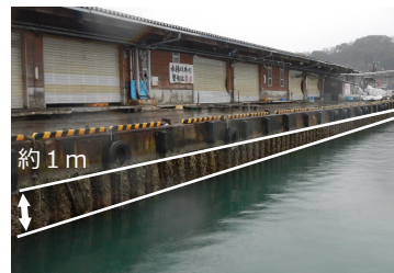
地盤の隆起による水深不足(輪島港)
