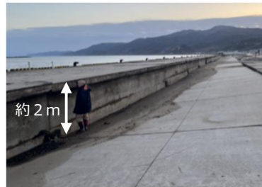
岸壁背後の沈下(輪島港)
