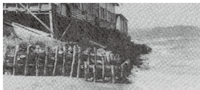
砂浜の後退により基部が露出した家屋
