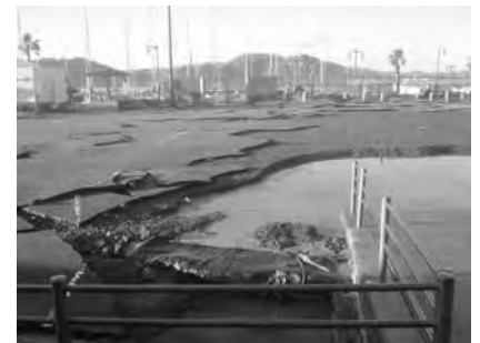
アスファルト散乱状況 (平成 21 年 10 月 8 日)
