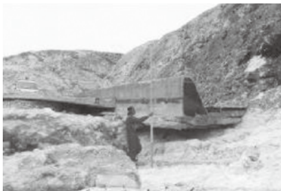
物揚場(-2.0m)上部工(L=18m)の被災及び 臨港道路コンクリート舗装等(L=110m)の被災
