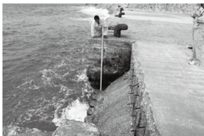
北大東港(西地区)岸壁上部工の被災(L=5m) (暴風時の波圧や巨石の影響ではないか)
