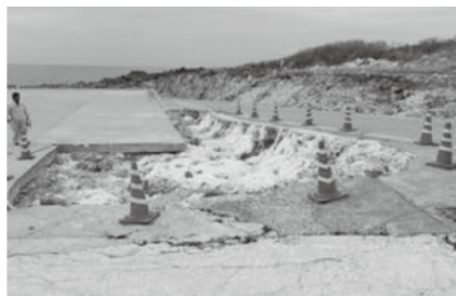
北大東港(江崎地区)臨港道路法面部の被災 (岸壁天端との高低差+13m地点での被災箇所)
