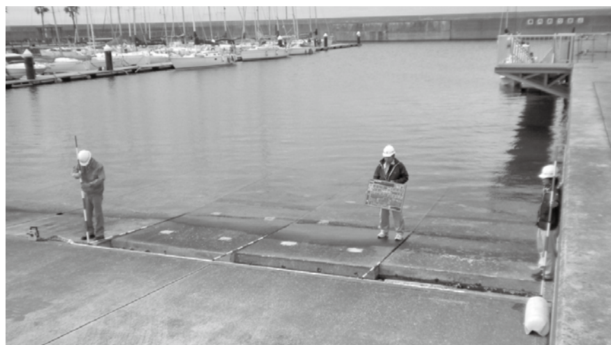
被災後(平成21年10月10日)
