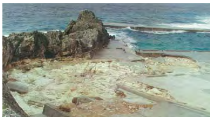
南大東港(道路・物揚場)の被災の状況
