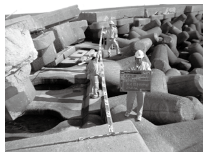
被災後(平成21年10月10日)
