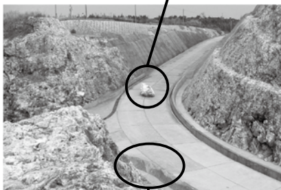
被災した物揚場等へ の進入口付近
