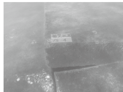
水中部被災状況(平成21年11月18日)
