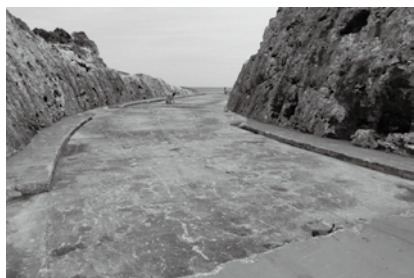
北大東港(江崎地区)臨港道路コンクリート 舗装(L=170m)の被災
