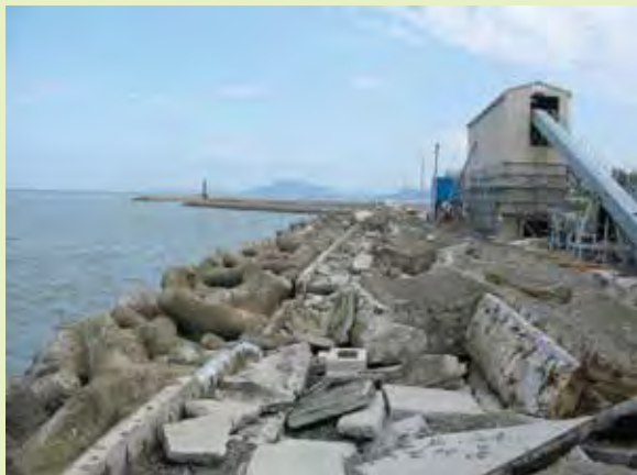
観音寺港観音寺堤防1号被災直後
