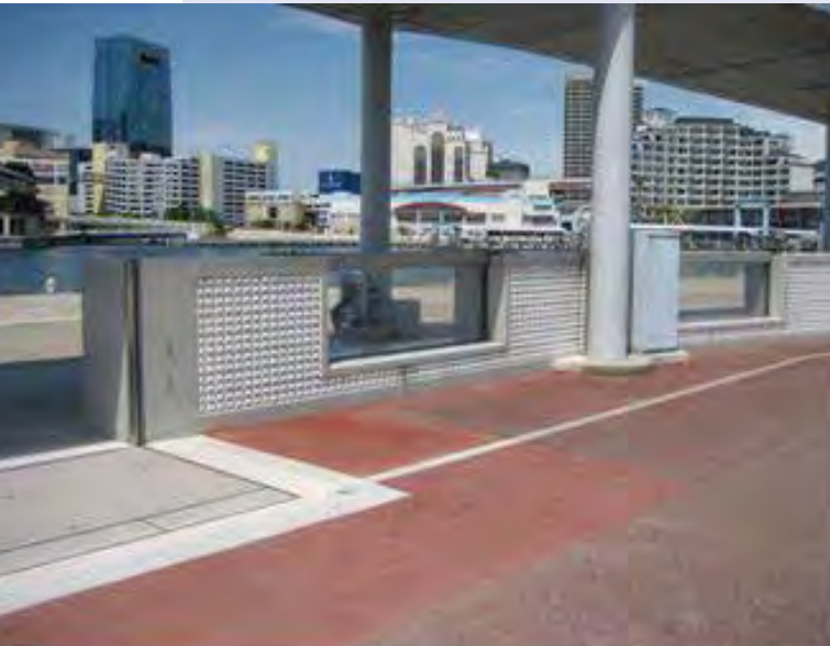
アクリル板を用いた防潮胸壁
