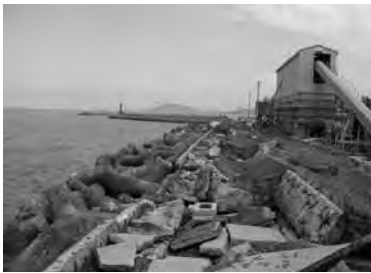
写真-5 観音寺港観音寺堤防1号被災直後 パラペット部分が根本から折れた
