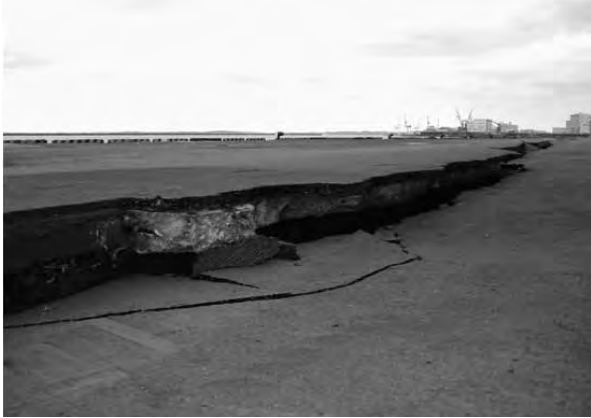
写真-3 箱崎ふ頭北-7.5m岸壁 (エプロンの亀裂・沈下状況)
