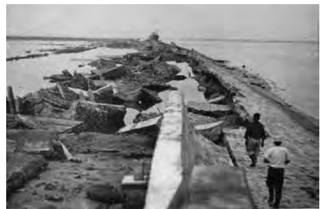
伊勢湾台風による破堤状況 (S34)
