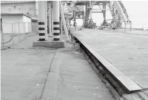
写真-5 須崎ふ頭-11.0m岸壁 波版の破損・背後地の沈下状況
