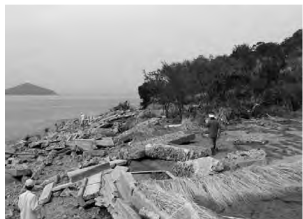
写真-4 多度津町高見島の崩壊した護岸
