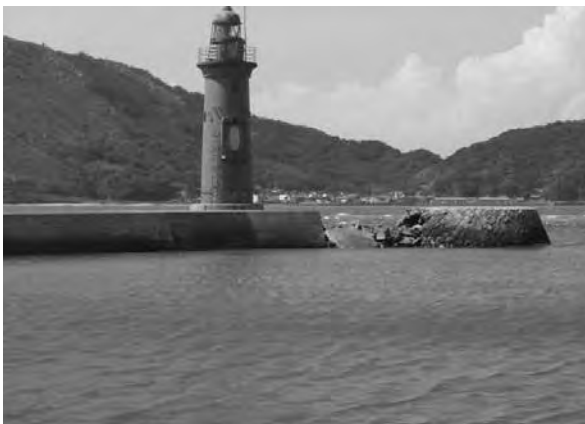
写真-3 丸亀市牛島里浦港の突堤被害
