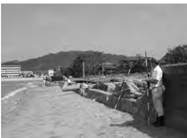
写真-11 仁尾港江尻2号護岸被災直後 パラペット部分が崩壊
