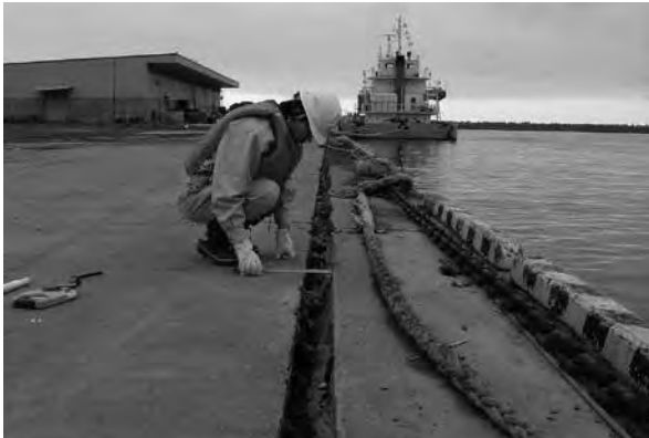
写真3 第3ふ頭第1岸壁・上部工変位
