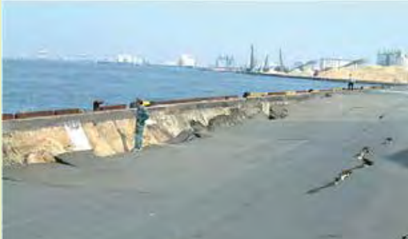
中央ふ頭北ー 5.5m岸壁（エプロン陥没状況）
