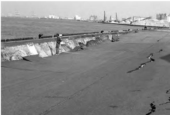
写真-4 中央ふ頭北-5.5m岸壁 (エプロン陥没状況)
