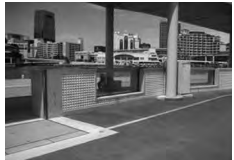
アクリル板を用いた防潮胸壁
