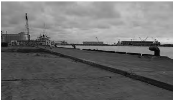
写真4 第2ふ頭第1岸壁・エプロン沈下
