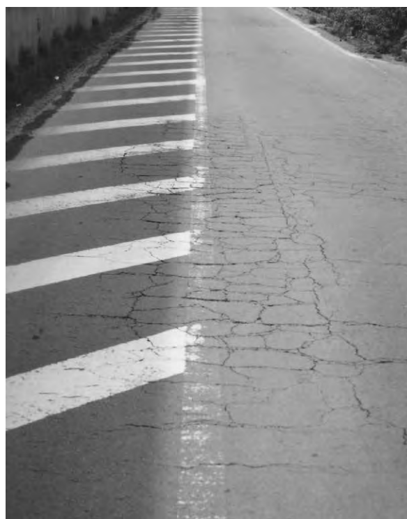
写真-3 代表的な被災状況 仙台塩釜港(仙台区)区画15号線
