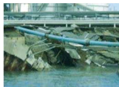
写真2 護岸の被災状況
