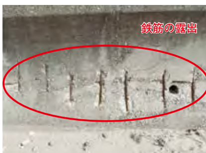
写真2 特Aランクの変状
