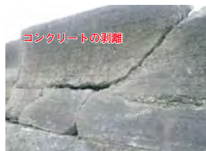
写真3 特Aランクの変状
