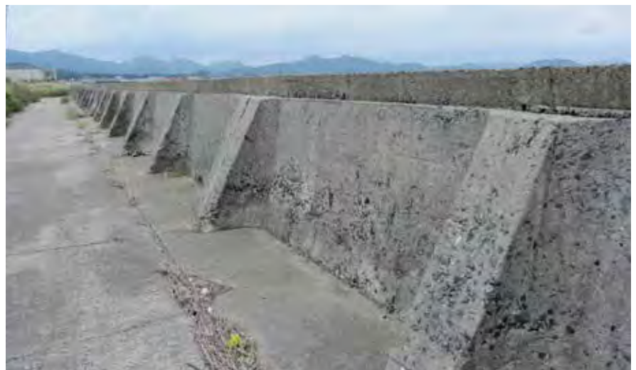
胸壁の変状事例
