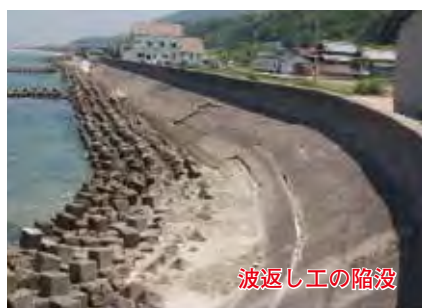
写真1 特Aランクの変状
