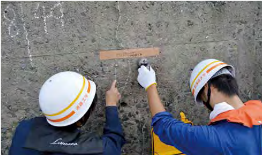
胸壁のひび割れ調査
