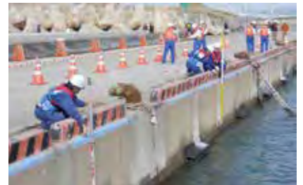
関東地整と茨城県による岸壁被災調査
