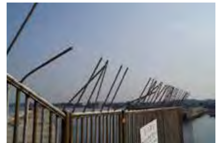
富具崎港禁止柵の被害
