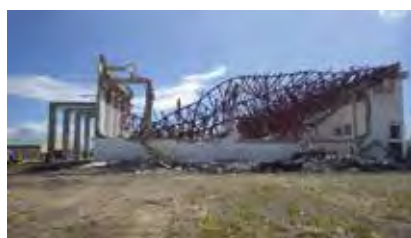
図10 屋根が落下したコンベンションセンター
