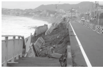
背後道路の被災状況
