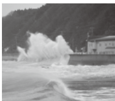
地盤沈下の影響による越波状況(奥尻港海岸)背後道路は小中学校の通学路。
