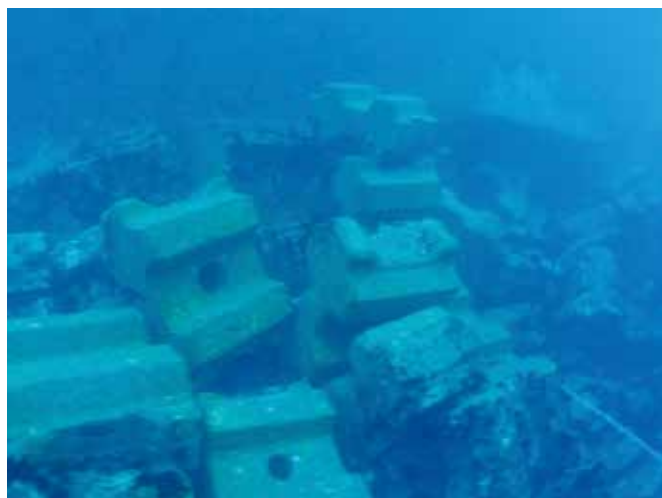
写真-2.2 飛散した被覆ブロック
