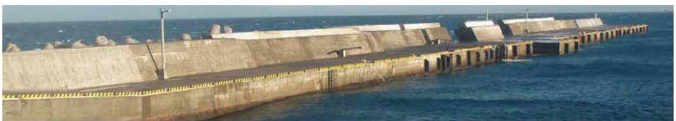
写真-2.1 西側岸壁被災直後
