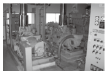
原動機・発電機(整備後)
