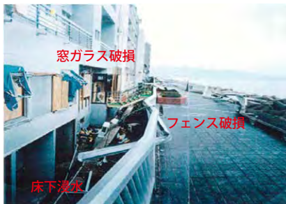
写真-2 台風による被災状況
