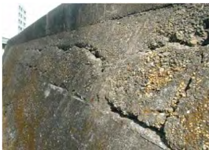
写真-1 施設の老朽化状況
