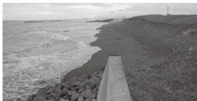
整備前状況:浜崖が浸食している
