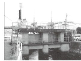
写真-1 J-ALERTによる自動化を行った水門(右上に受信アンテナ、左上に制御盤等を設置)
