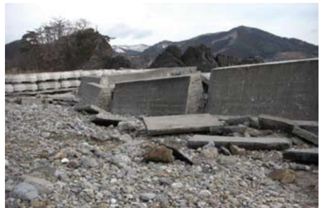
岩手県 大船渡港 護岸 【補助災】
