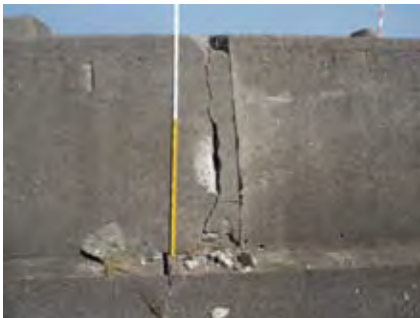
護岸のひび割れ状況
