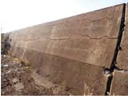
護岸のひび割れ状況
