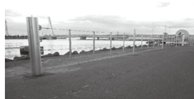
漂流物防護柵(設置状況)
