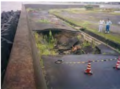
水叩きの陥没状況
