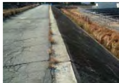
写真-3 老朽化した堤防
