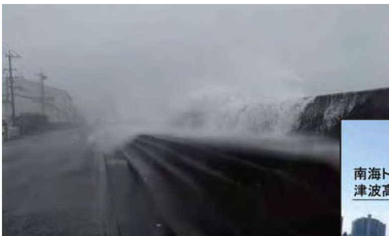
図-3 既存護岸の越波状況：大分港海岸
