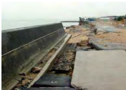
写真-2 平成16年台風による護岸崩壊
