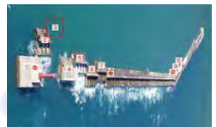
名瀬港沖防波堤居被災状況
