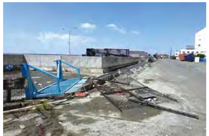
写真-2 大阪港のSOLASフェンス、ゲート倒壊
