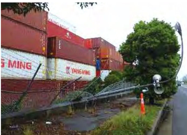
写真-1 神戸港のSOLASフェンス倒壊
