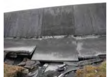
苫小牧港護岸水叩き陥没
