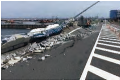
図一七 はま道路の損傷状況
