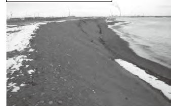
波浪による侵食で、土羽堤防(盛土)が削られている。
