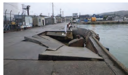
伏木富山港 岸壁の倒壊
