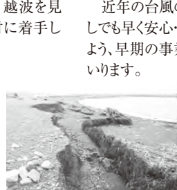
流出防止施設の被災状況(平成26年 台風11号)
