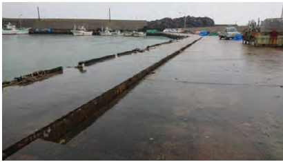
鼠ヶ関港 物揚場エプロンの沈下
