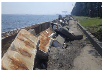
横浜港 護岸胸壁の倒壊
