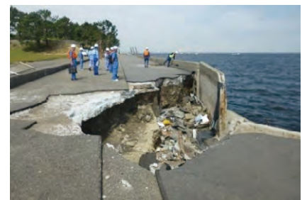
図—5 金沢地区福浦の護岸倒壊状況
