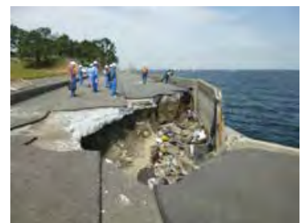
横浜港金沢地区の護岸被災 (令和元年台風15号)
