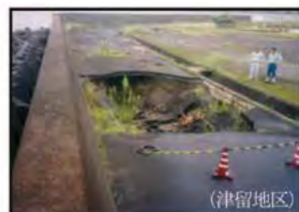
写真-3 陥没状況
