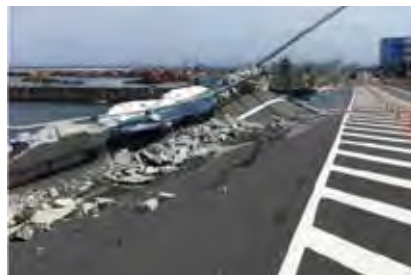
写真-1 船舶衝突による横浜港南本牧はま道路の損傷
