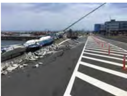
横浜港南本牧はま道路への船舶衝突 (令和元年台風15号)
