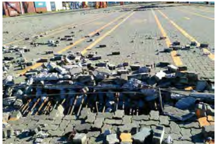
川崎港C Tの棧橋被災 (令和元年台風19号)
