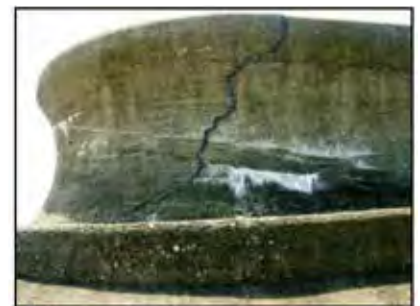
写真-2 海岸堤防に発生したひび割れ
