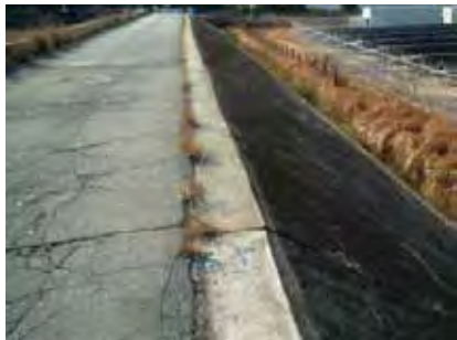
写真-3 老朽化した堤防
