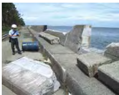
図-1 横浜港における高波による護岸倒壊事例（令和元年房総半島台風）
