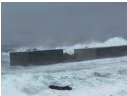
湯泊港 防波堤の倒壊
