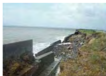
三池港海岸 護岸の倒壊
