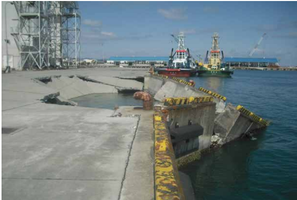
1号ふ頭第4・5号岸壁の陥没・倒壊
