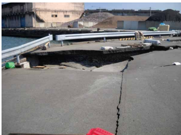
東ふ頭岸壁に陥没の状況
