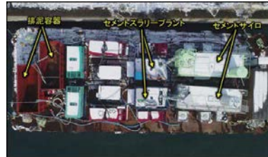
写真9 台船上に配置したプラント
