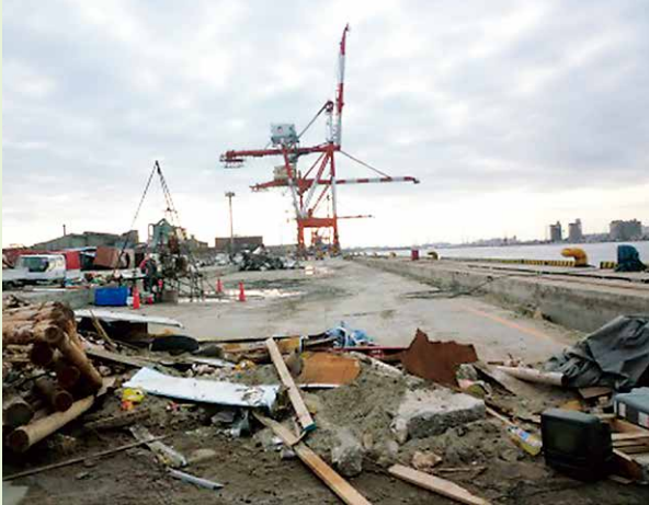
高砂ふ頭1号岸壁(復旧前)
