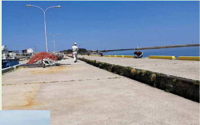
鼠ヶ関港 鼠ヶ関物揚場 (復旧前)
