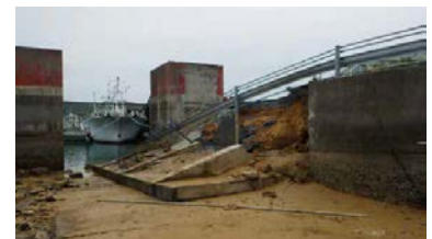
港湾施設の被災状況 （合津港：護岸崩壊）
