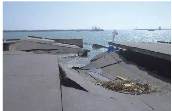
被災したふ頭の先端部分
