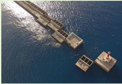
被災直後(大きく被災した防波堤の一部)
