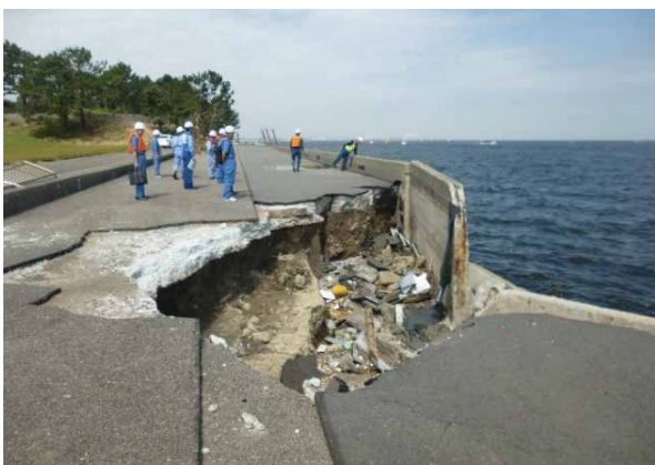
横浜市金沢区における被災護岸調査状況
