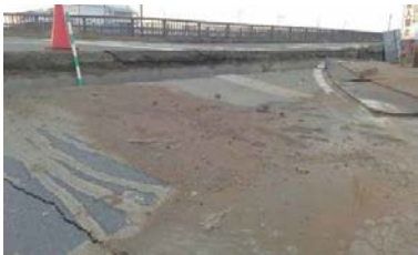
熊本地震直後の被災状況写真
