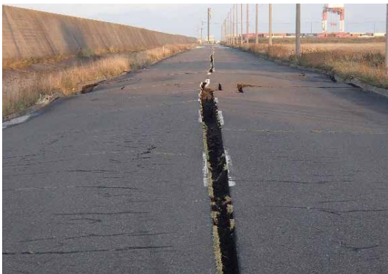
臨港道路の亀裂
