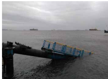
写真3 海中に落下した海づり栈橋
