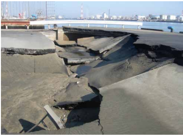
南公共埠頭A岸壁におけるエプロンの陥没
