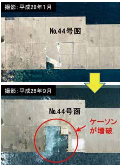
写真4 ケーソン増破状況
