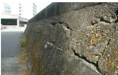
写真-2 護岸の老朽化状況
