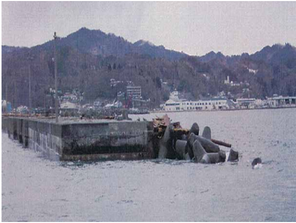
藤原防波堤の被災状況 (先端部約20m (灯台含む) 沈没)
