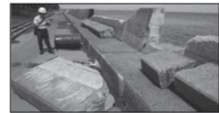
高波による護岸倒壊 (令和元年房総半島台風での横浜港の事例)
