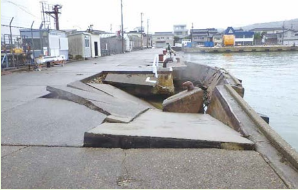
伏木富山港(伏木地区)国分1号岸壁被災状況
