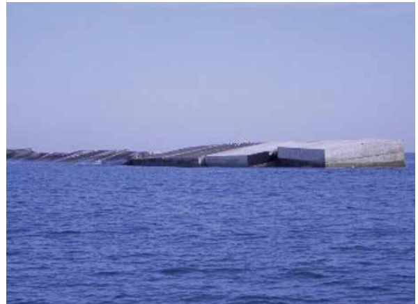
沖防波堤の被害状況
