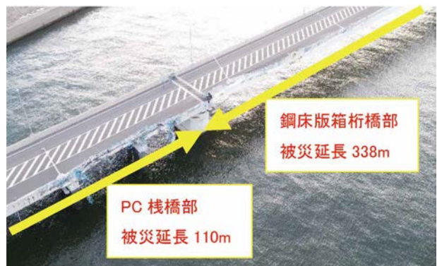
写真-3 被災状況
