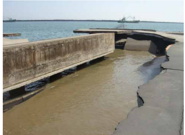
岸壁先端部の流出 (第4ふ頭D岸壁先端)
