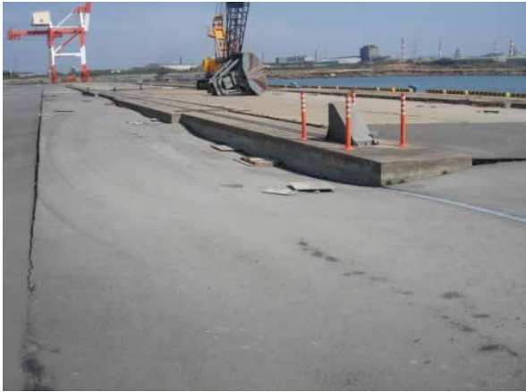
北公共埠頭D岸壁におけるエプロン端部の段差
