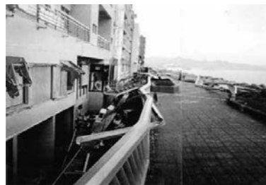
写真-3 高潮・高波による旅館への被害
