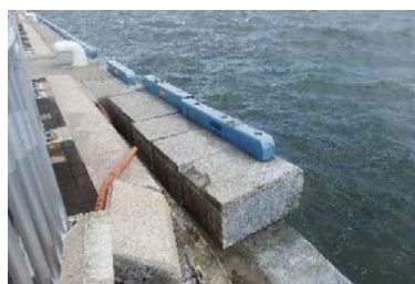
写真-3 新港第1突堤被災状況 (2)
