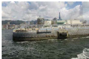
写真-2 新港第1突堤被災状況 (1)
