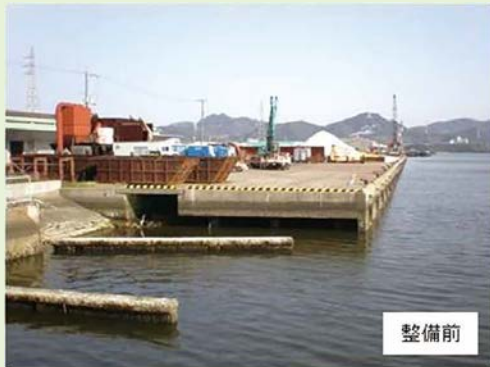
平成16年台風16号 立川護岸 被災状況
