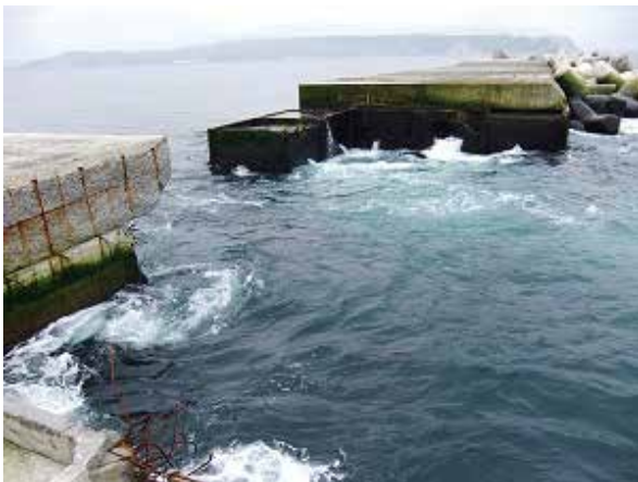
被災した湾口防波堤
