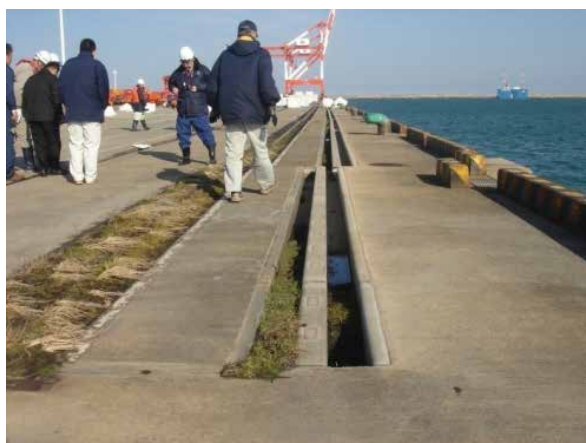
ガントリークレーンのレールのずれ（北ふ頭C岸壁）
