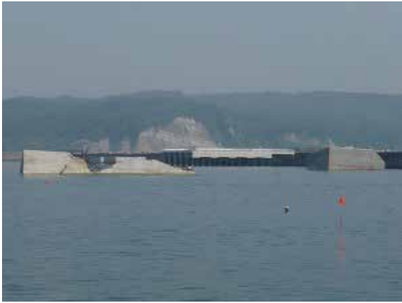
漂流物がぶつかって破損した仮置きケーソン
