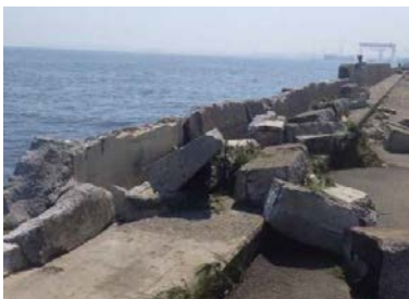
写真1 福浦地区護岸の被災状況
