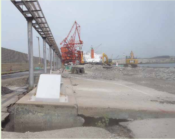
小名浜港7号ふ頭(復旧前)
