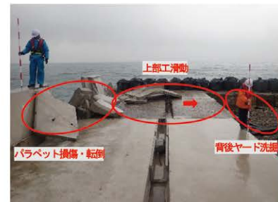
写真-2 被災状況②
