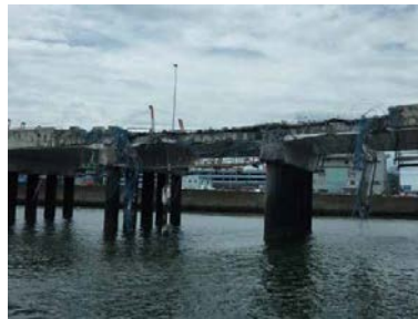
写真2 破損した南本牧はま道路
