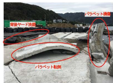
写真-1 被災状況①
