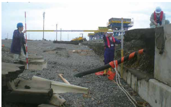
地震により液状化したエプロン背後の状況
