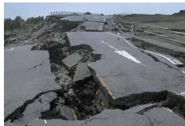
路面の崩壊（阿蘇市）
