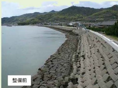
平成16年台風16号 南浦護岸 被災状況
