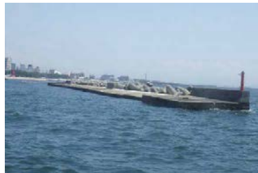
写真-1 須磨離岸堤被災状況
