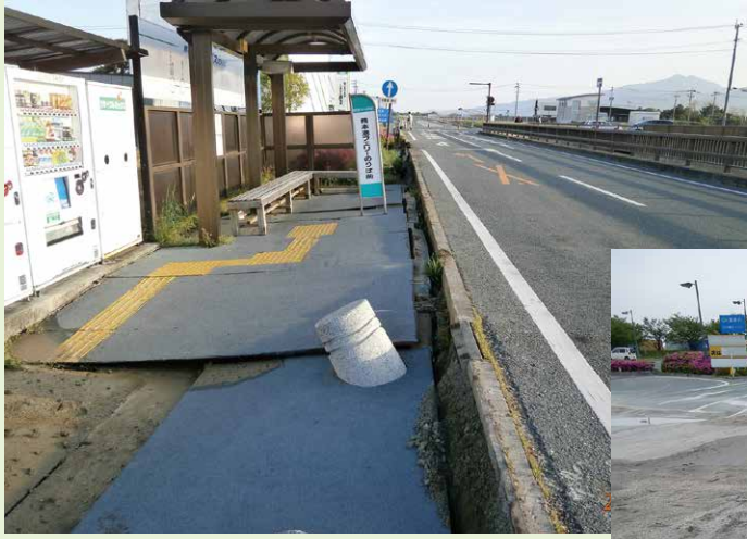
熊本港バス停(沈下状)
