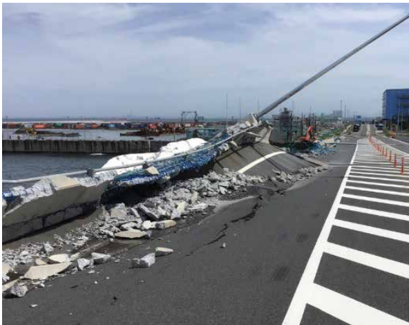
南本牧はま道路の被災状況
