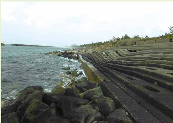
平成31年冬期風浪 傾斜護岸1 被災状況
