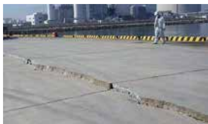
(相馬港 地震による地盤沈下)
