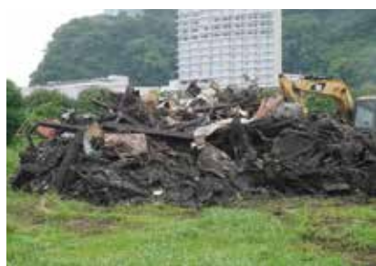
写真8 仮置きされたガレキ (7/10)
