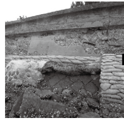
老朽化した護岸
