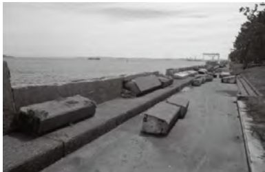
パラベットの倒壊
