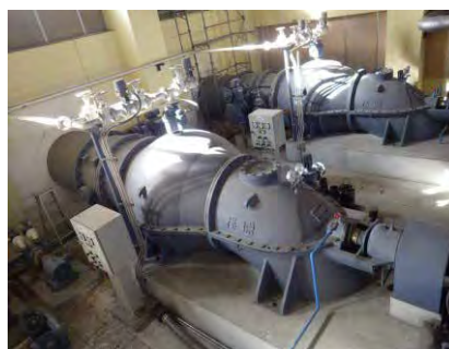
写真-1 黒江排水機場のポンプ設備
