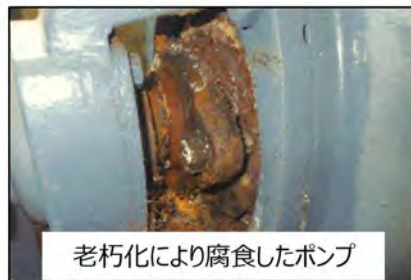
写真1 構造物の老朽化状況
