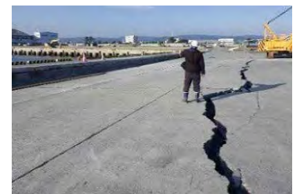
【写真3】被災状況 (2号ふ頭)
