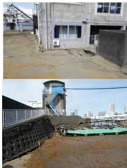
写真4 船橋排水機場液状化状況
