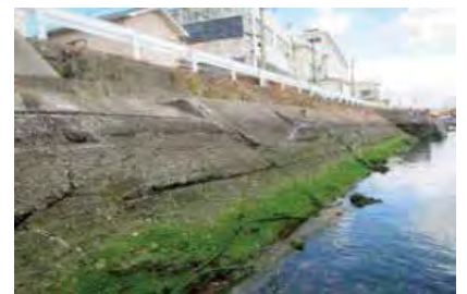
写真-2 護岸老朽化状況
