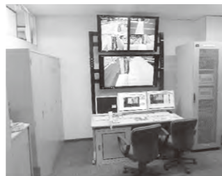
監視操作局(事務所)
