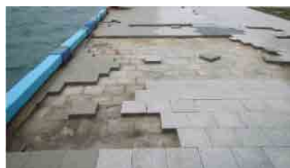
(b) 郷ノ浦港(長崎県) インターロッキング剥離
