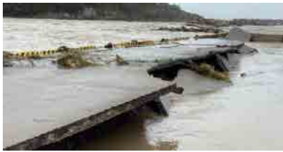
(a) 美々津港(宮崎県) 物揚場の倒壊
