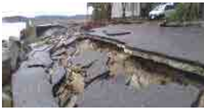
(b) 守江港(大分県) 護岸の損傷
