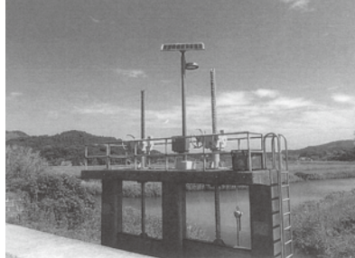
樋門の作業灯
