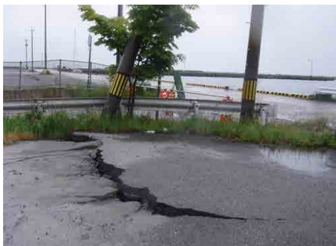
写真1 飯田港における被害の様子
