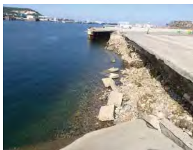
図-9 安房港物揚場の被災状況
