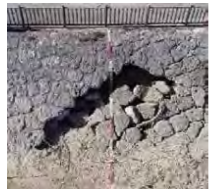
図-11 金武湾港護岸の被災状況
