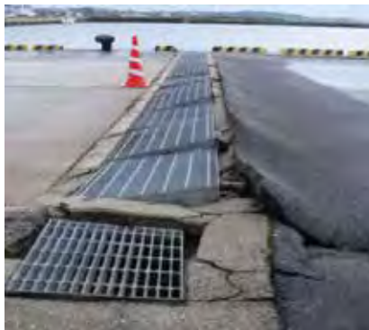
図-2 飯田港 岸壁の変動状況
