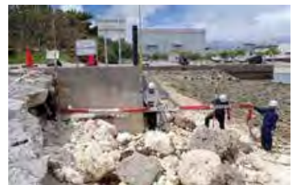
図-10 中城湾港防波堤の被災状況
