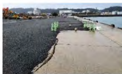
(3) アクセス経路にうねりが生じていたため、応急復旧を実施（1月9日）
