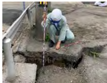
図-3 飯田港 地震による地盤沈下状況
