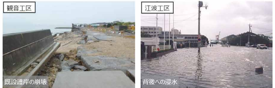
写真-1 平成16年台風18号による被害状況
